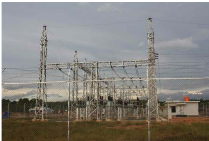
Substasiun kelistrikan telah dibangun untuk berfungsi sebagai pusat sumber listrik
