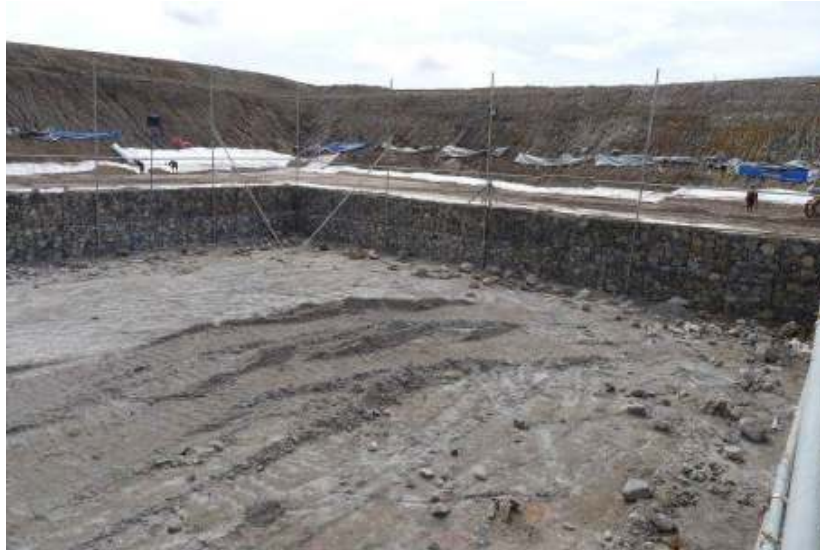
Lokasi peremukan lapisan penutup
